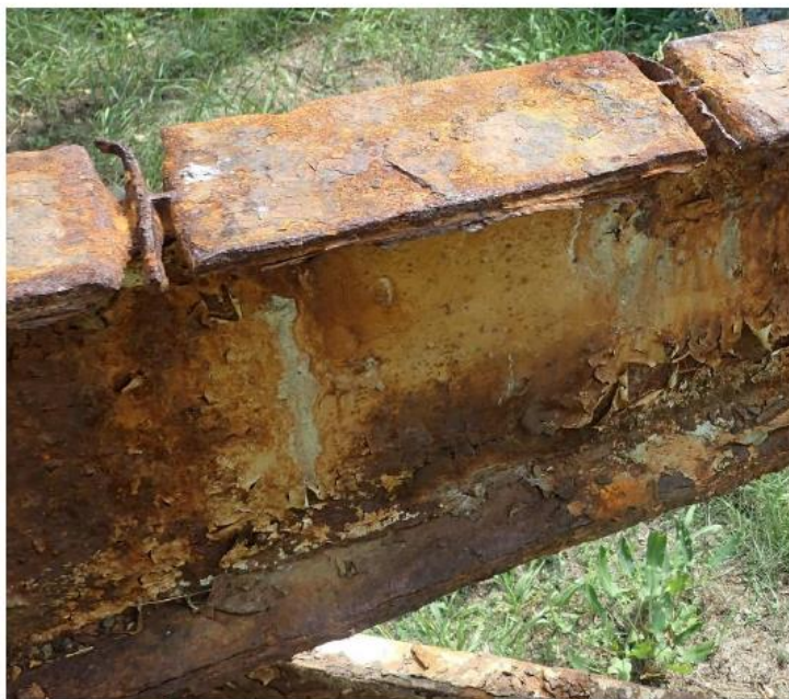
Koroze pod lokálním tlakem železničního pražce, použitého pro mostovku (most plukovníka Šrámka)
