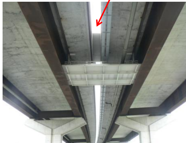
nedostatečné zakrytí zrcadla
