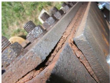
(a) Spárová koroze stožáru v místě příložkového spoje nárožníků
