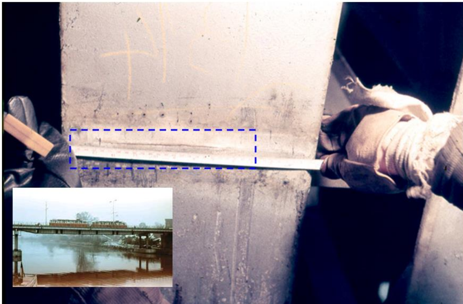
Únavová trhlina - Tramvajový most přes Vltavu v Holešovicích
