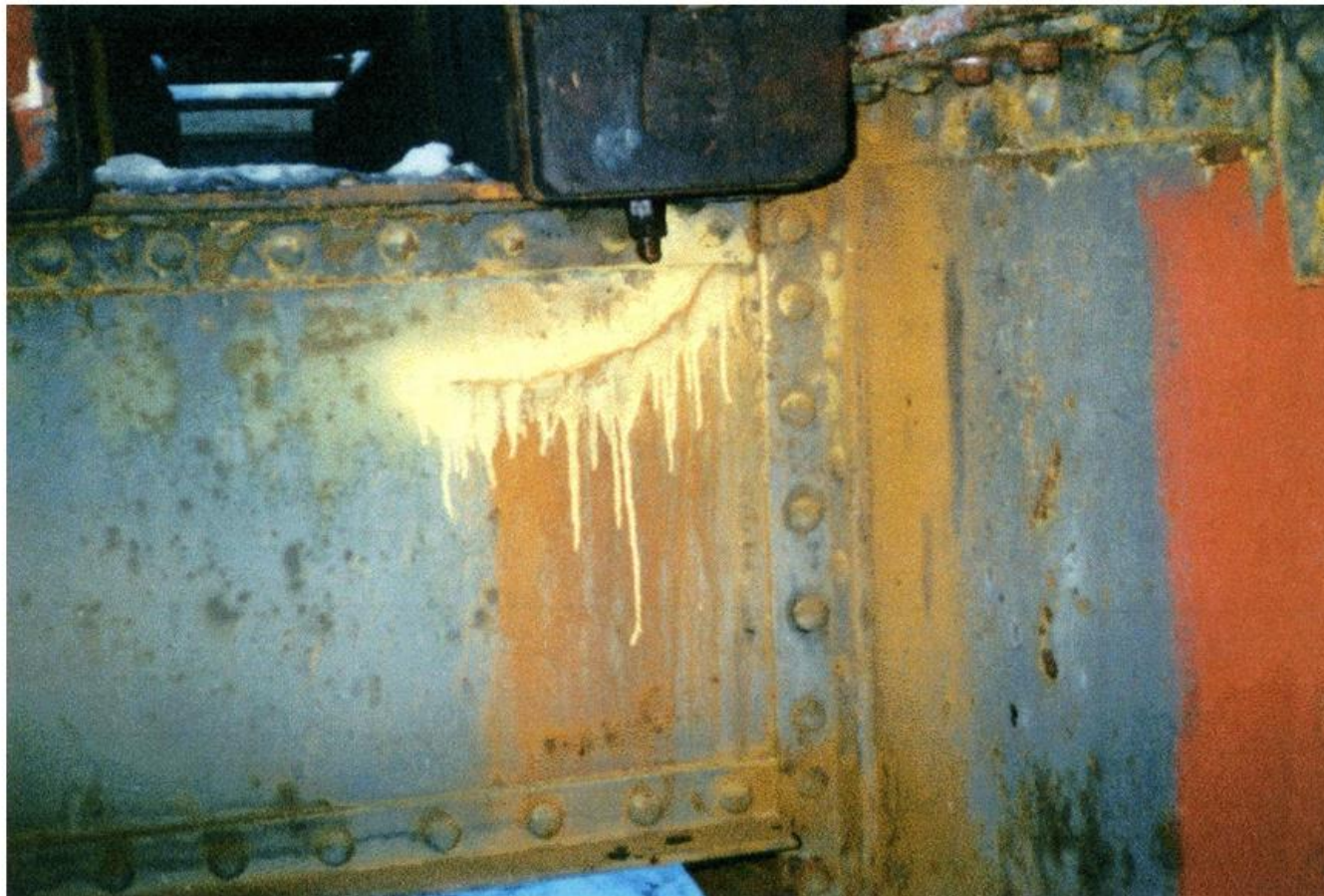
Únavová trhlina - Ocelový železniční most u Hodonína (1929)
