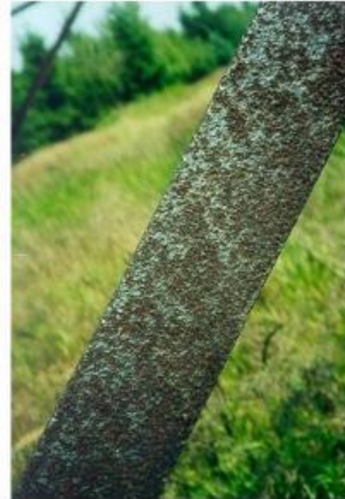
Patinující ocel - méně ochranná vrstva patiny
